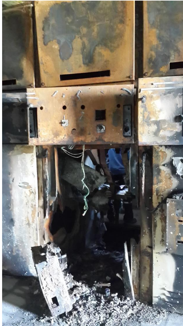
Fig 4 - Frente de celda 13,2kV de Trafo N° 2
