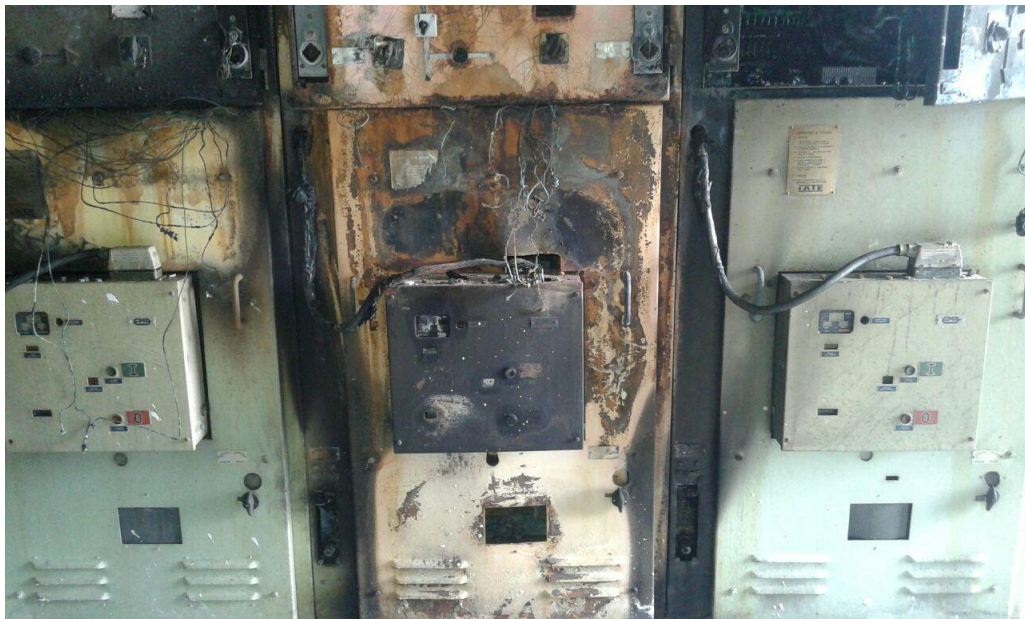
Fig 1 - De izquierda a derecha: Frente de celdas 13,2kV de Salidas N° 8, 9 y 10
