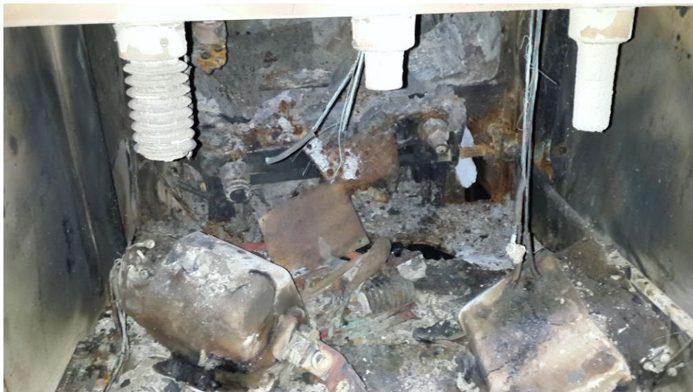
Fig 2 - Vista trasera de celda 13,2kV de Salida N°9
