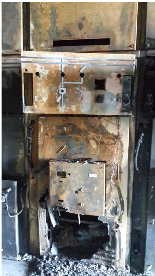
Fig 3 - Frente de celda 13,2kV de Trafo N° 1
