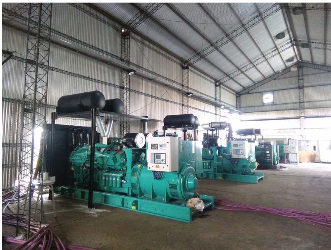
Imagen 1 disposición de los 4 primeros grupos dentro del galpón de la usina Tostado
